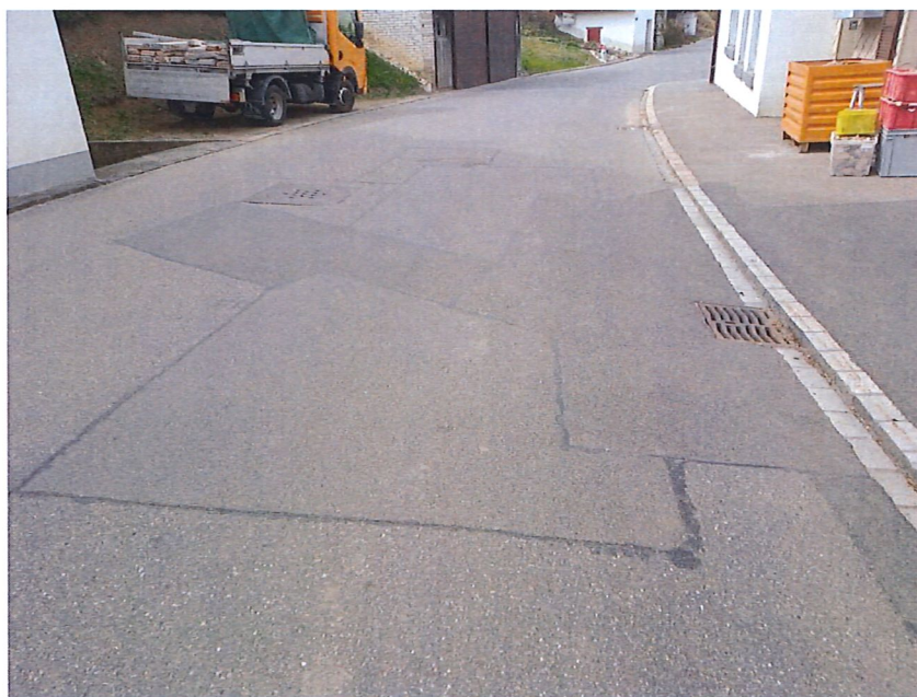
Abbildung 5 Allgemeiner Zustand Fahrbahn
