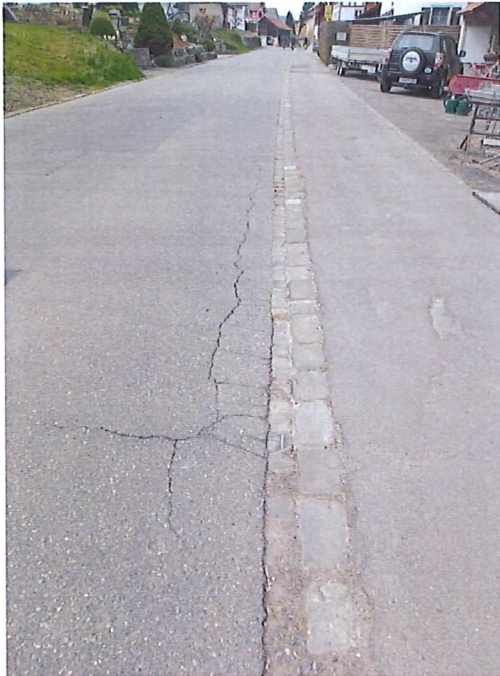
Abbildung 6 Risse im Fahrbahnbelag / Schäden im Gehwegbelag
