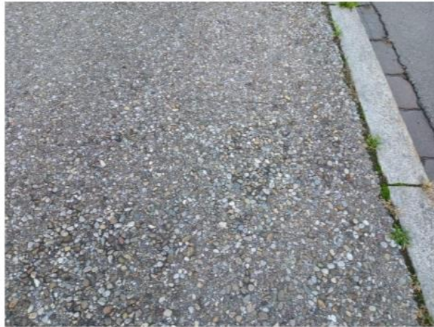
Starke Ausmagerung im Gehwegbelag
