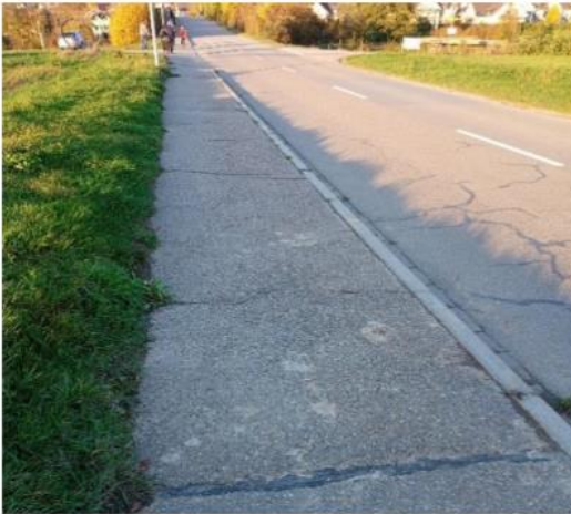
Typische Schadensbilder Gehwegbelag
