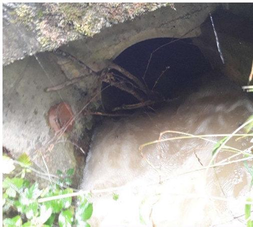
Teilverklauter Einlauf (29.10.2020) des Durchlasses e5 unter der Dorfstrasse.
