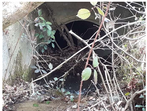
Teilverklauster Einlauf (26.03.2020) des Durchlasses e5 unter der Dorfstrasse.
