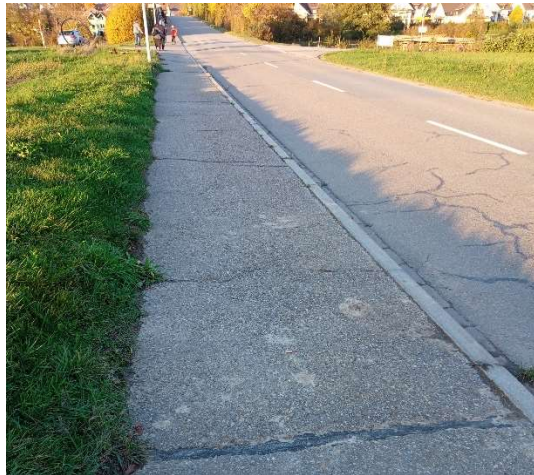
Typische Schadensbilder Gehwegbelag
