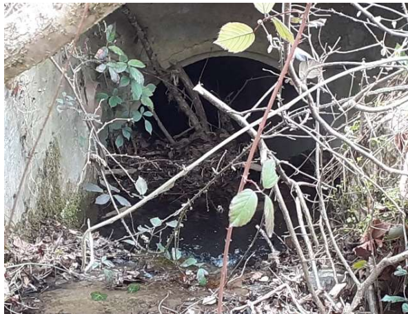
Teilverklauter Einlauf des Durchlasses unter der Dorfstrasse (Sh3).
